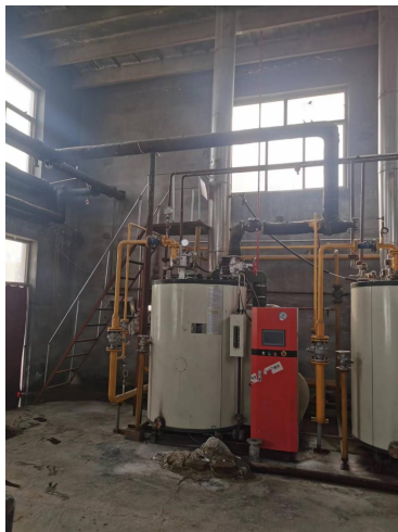
锅炉低氮燃烧器
